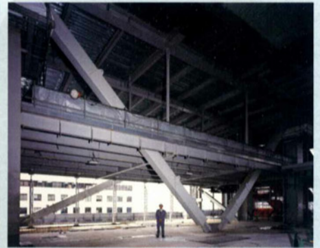
●長尺仕様(部材長22m) 1998年 大阪国際会議場(大阪府) 設計: 大阪府建築部/黒川・イブスタイン・アラップ 共同企業体
